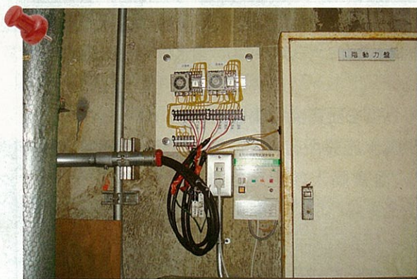
デマンド監視装置の取り付け
